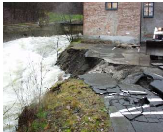
Flomskade Nydalen 2000. Foto: Oslo kommune, Vann og avløpsetaten
